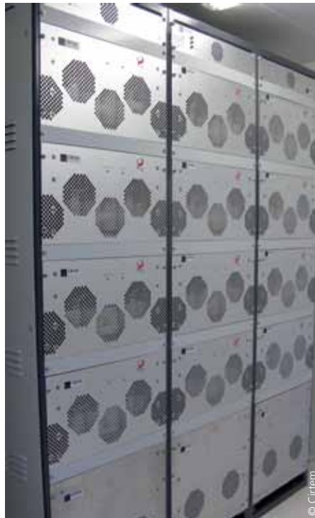
Photo des baies réalisées dans le cadre du projet Smart ZAE
